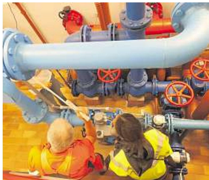
So einfach ist die Wasserversorgung: Was für den Laien kompliziert aussieht, hat für den Experten Ordnung und Sinn.
