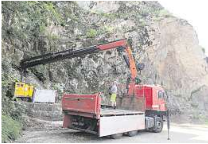
Die Firma Sachtleben Mining Services beim Einrichten der Baustelle. Im Hintergrund die zu bearbeitende Felsfläche.
